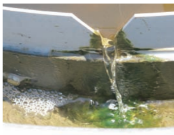
処理水(沈殿槽出口)
