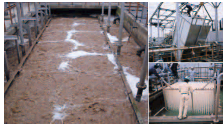
豆腐廃水、BF充填後能力×3倍、汚泥減消
