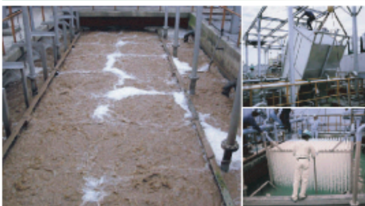
豆腐廃水、BF充填後能力×3倍、汚泥減消
